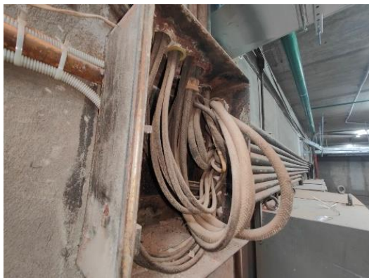
Рис. 1. Нарушение целостности проводов в осях 18-20/Н-Р
